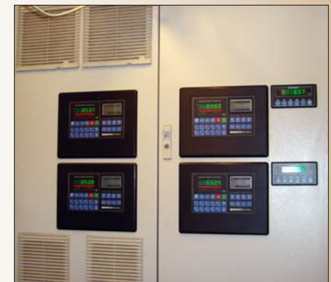
Overzicht van de besturingskast.
